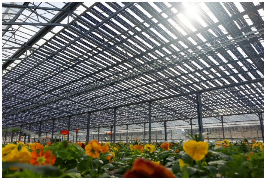
Repowering des serres horticoles photovoltaïques des Floriades de l'Arnon (18 - Cher) - Crédit photo : Feedgy
